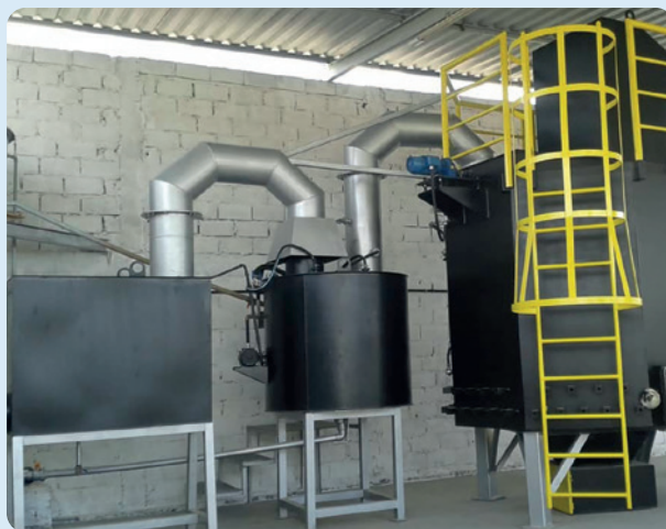
IMAGEM 10: usina de pirólise do lixo.
