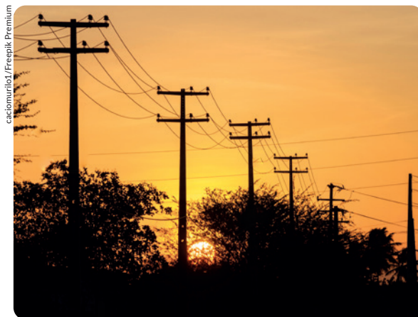
IMAGEM 10: postes da rede elétrica.
