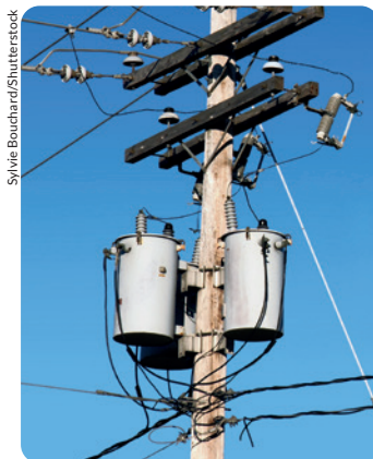
IMAGEM 13: transformador e linhas de energia no poste de eletricidade.
